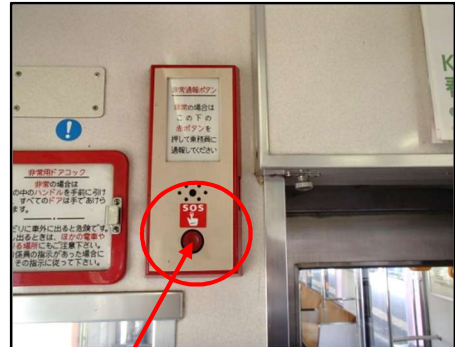
非常通報ボタン
