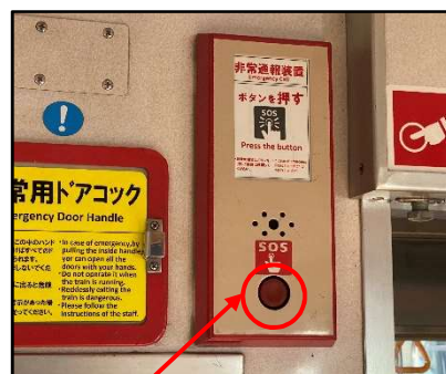
非常通報ボタン
