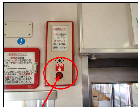
非常通報ボタン
