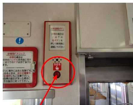
非常通報ボタン
