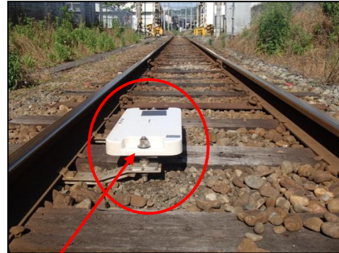
トランスポンダ地上子
