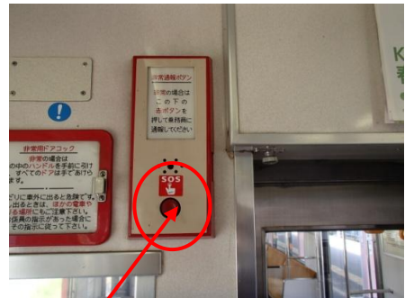
非常通報ボタン
